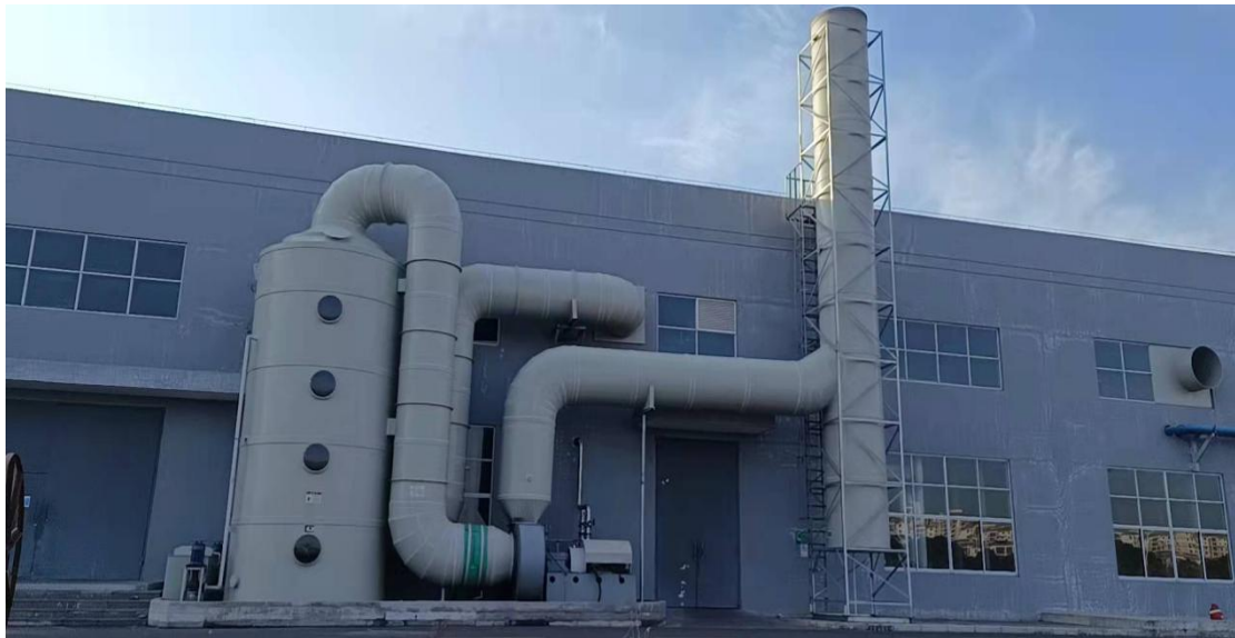
图 3-3 切片废气处理设施
