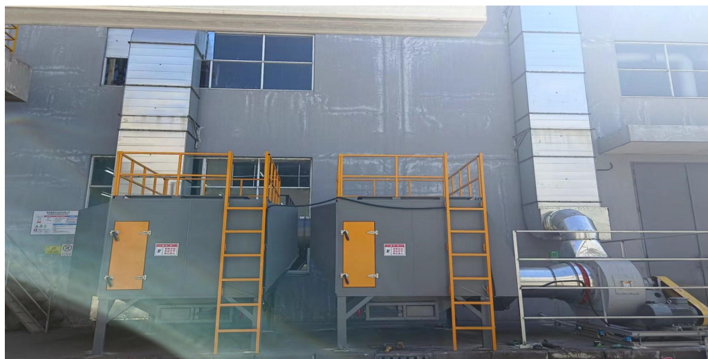
图 3-14 改造后的粘结固化废气处理设施
