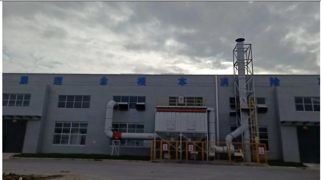
图 3-6 破碎废气处理设施
