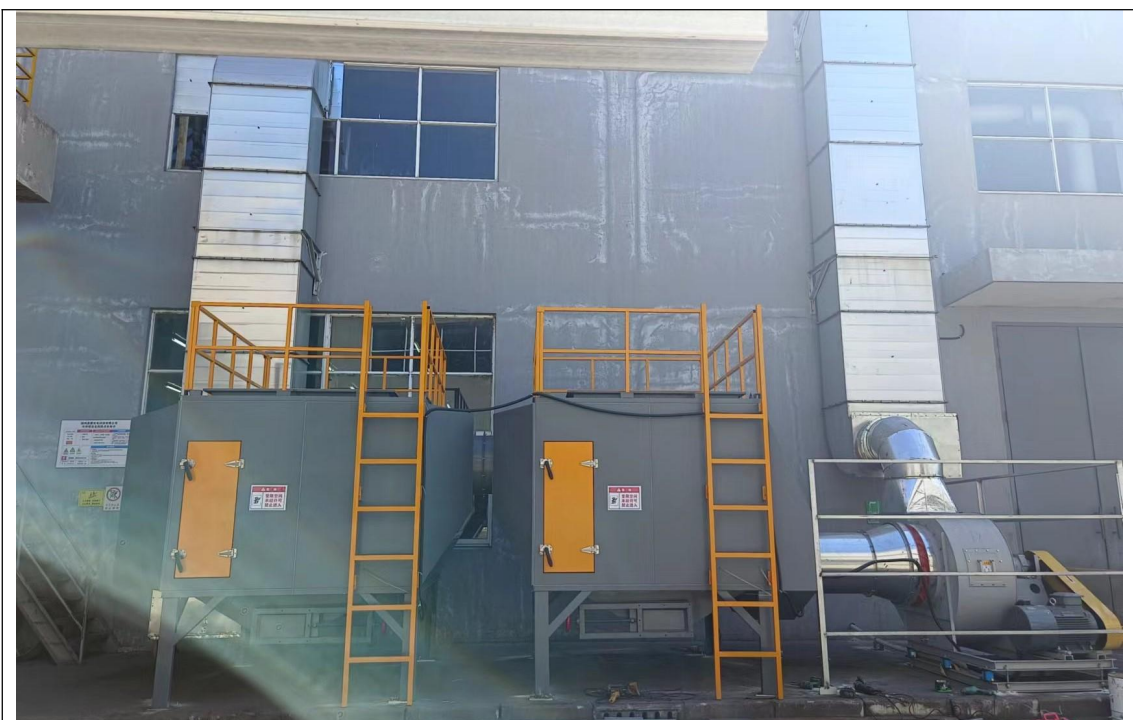
图 3-4 粘棒、固化废气处理设施
