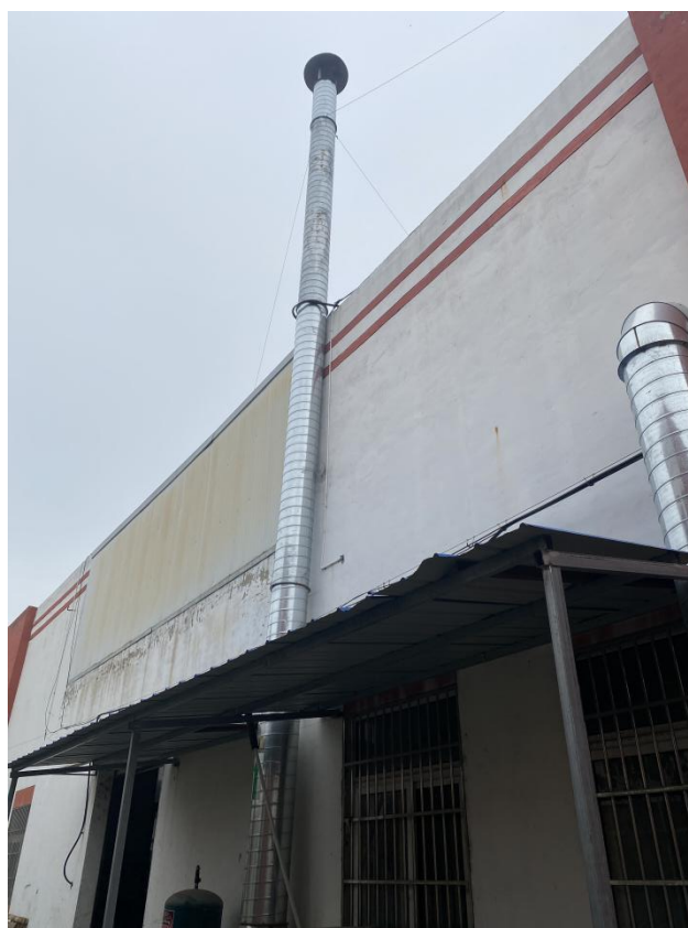
图 2-5 废气处理设施及 15 米高排气筒 DA001
